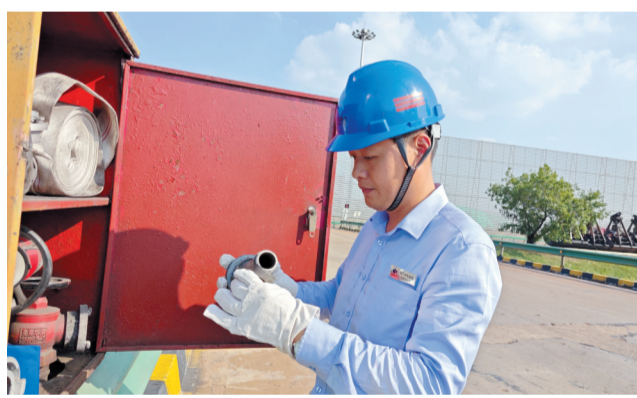
消防安全月期间，消防专员正在进行消防器材的点检，保障消防设备安全可靠。 东港公司 朱兵 摄
