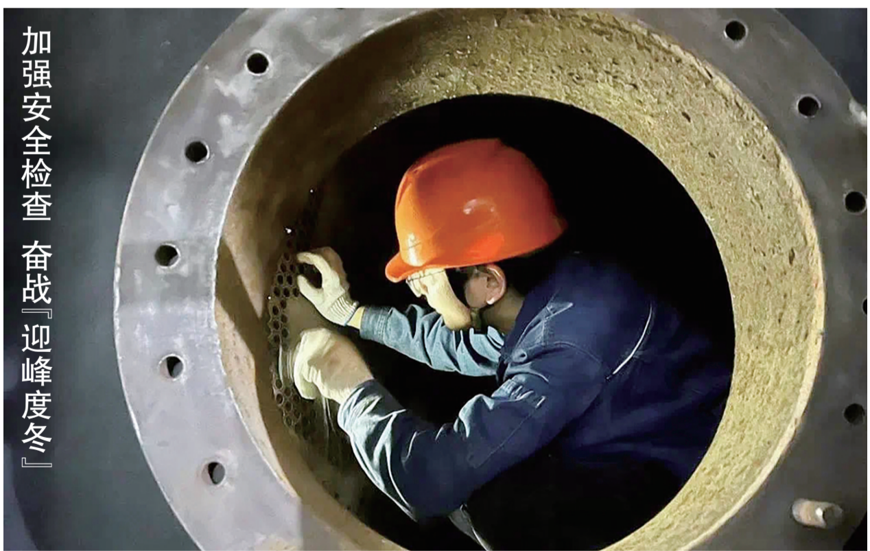
11月20日,江苏华电向容发电有限公司的维保人员在进行设备安全检查。近期气温骤降,城市居民用电负荷显著上升,为全力做好迎峰度冬工作,该公司连日来扎实开展设备安全大检查,确保各设备系统安全稳定运行。张梅 李斌 摄影报道
