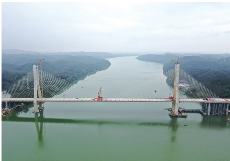
12月10日,广西上横(上林县至横州市)高速公路西津郁江特大桥顺利合龙。据了解,上横高速公路是广西交通基础设施建设的重要项目,西津郁江特大桥是上横高速公路一期工程全线唯一控制性工程,桥梁全长1190米,主桥长680米,主跨400米,为双塔双索面钢混组合梁斜拉桥。 新华社发
