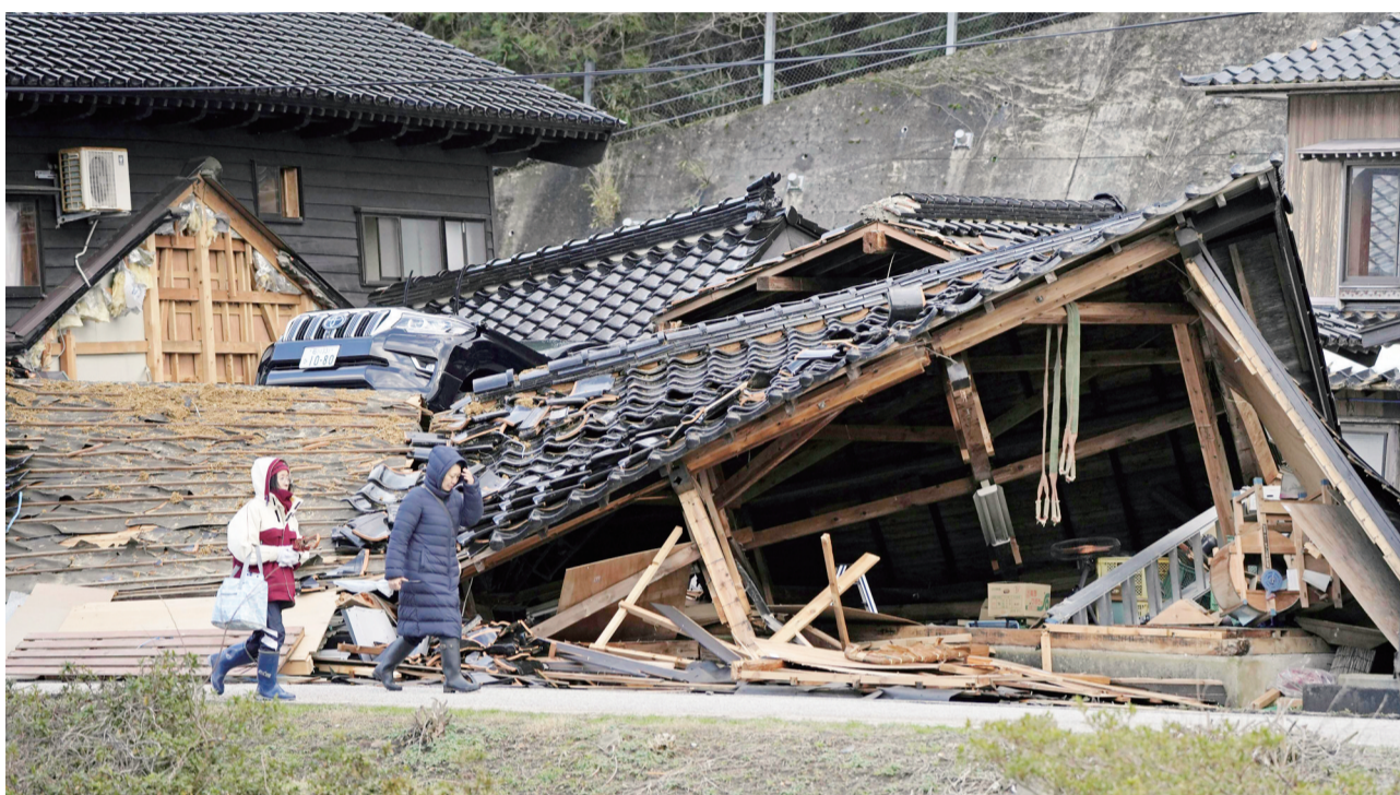
在日本石川县珠洲市,人们经过遭地震损毁的建筑。
