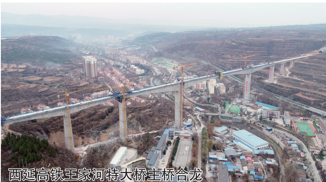
西延高铁王家河特大桥主桥合龙。11月15日,由中国铁建大桥工程局承建的西(安)延(安)高铁王家河特大桥主桥顺利合龙。王家河特大桥位于陕西省铜川市王益区境内,全长1066.7米,是西延高铁全线跨度最大、高度最高的桥梁。西延高铁是陕北革命老区首条高速铁路。项目建成后,西安至延安的铁路运行时间将从目前的2个半小时缩短至1小时左右,对便利沿线群众出行、巩固革命老区脱贫攻坚成果有重要意义。新华社发
