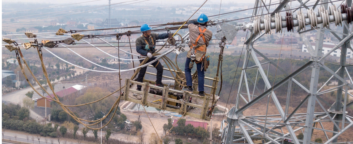
春节即将来临，在丹徒区上党镇500千伏输电工程施工现场，电力工人们坚守岗位，在百米高空架设高压线路，积极推进工程建设，力争早日并网通电。 王亮 陈泽 李斌 摄影报道
