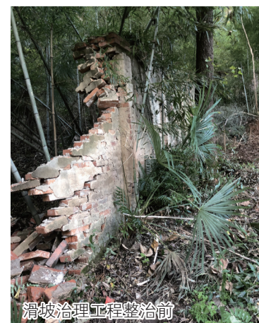
滑坡治理工程整治前
