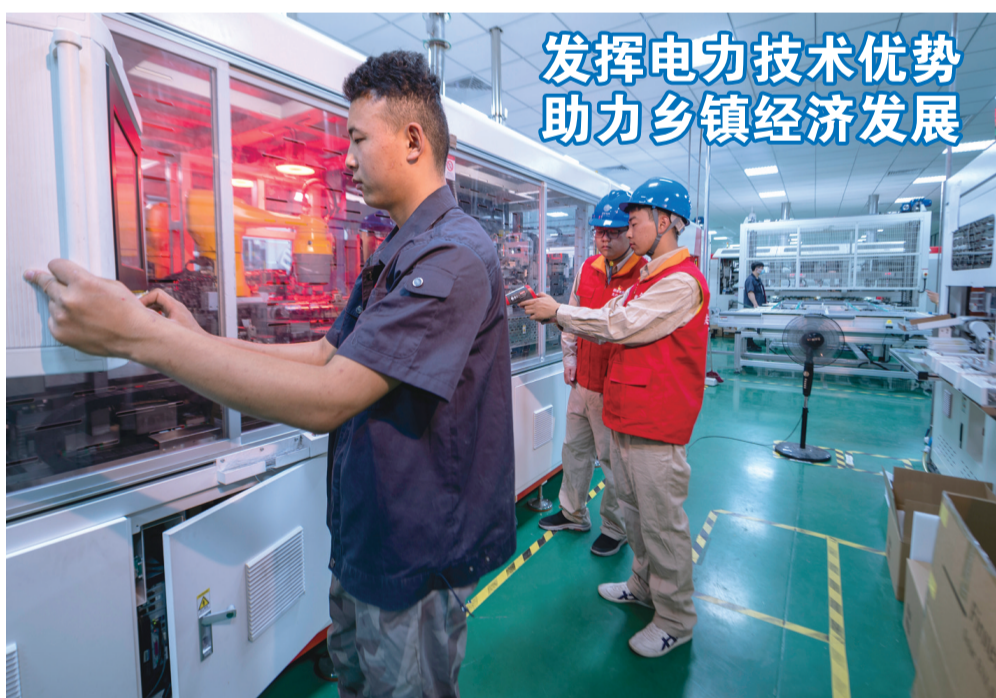
6月16日,在扬中油坊镇镇迈新能能源科技有限公司的生产车间,油坊镇供电所党员服务队的工作人员正在使用红外测温枪对生产设备进行测温,确保夏季企业设备安全稳定运行。黄楠 宋伟 李斌 摄影报道
