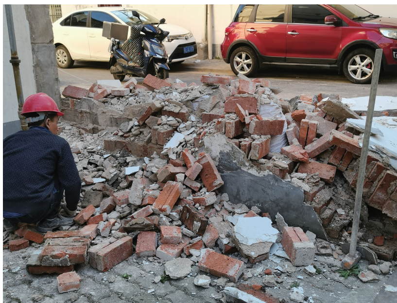
社区及时处理老旧小区危墙，排除安全隐患。陈经纬 袁珊 摄
