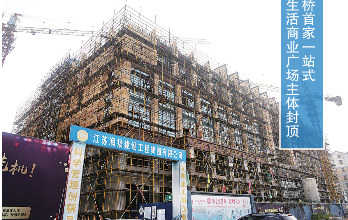
日前，高桥镇为民办实事项目乾德商业广场商业综合体完成主体封顶。据了解，该项目总投资9500多万元，占地面积约9000平方米，是高桥镇首家一站式全生活商业广场，主要用于经营雪地靴开发、零售以及超市、餐饮、酒店等实体经济。预计整个工程将在明年4月份正式交付使用。 王媛 李军杰 摄影报道
