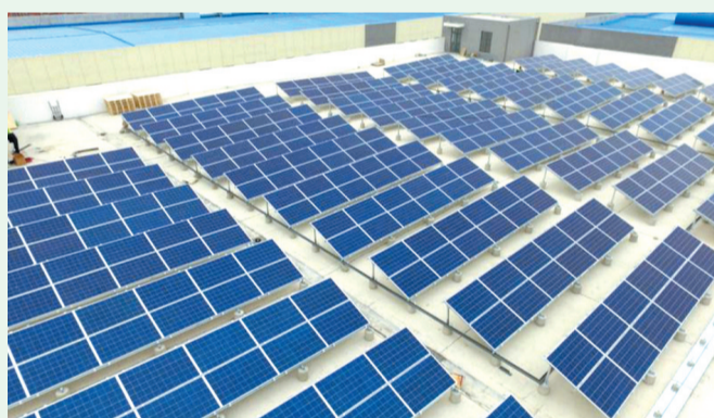
夏王村光伏发电扶持项目
