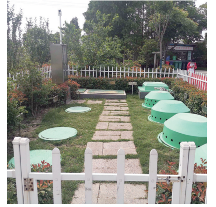
大荆村污水处理设施。继业 摄
