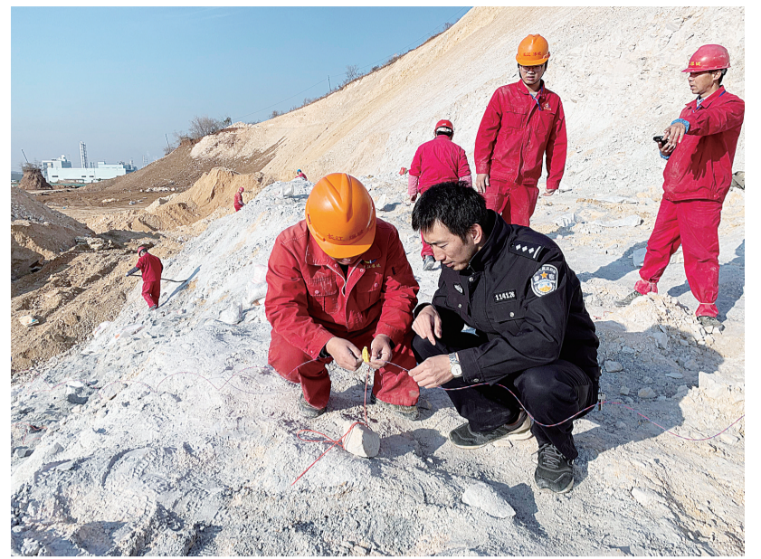
大港派出所民警检查爆破工地火工品分发、使用、保管等安全
