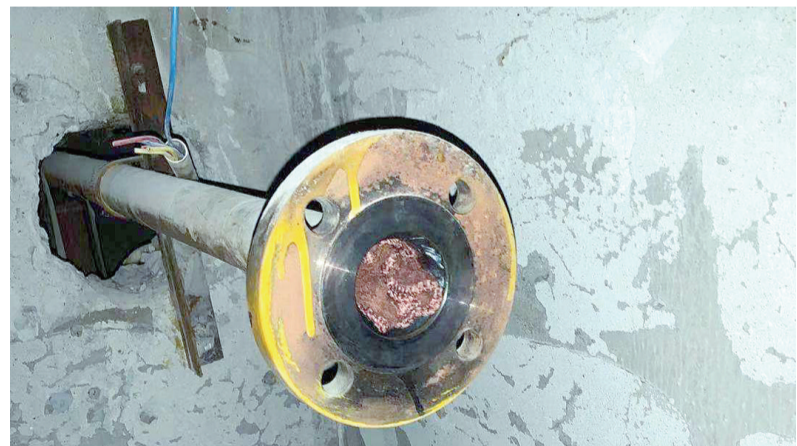
图为超市内拿抹布堵着的管道敞口漏气 徐国平 摄
