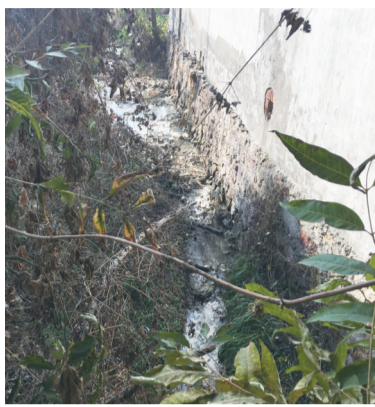
乔家门社区东三组23号民居边的明沟,垃圾遍地,污水横流。
