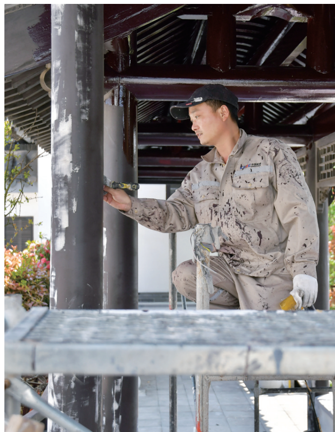
4月10日,工人正在对位于丹徒区高资街道水台村的闻捷诗歌馆进行修缮与出新。闻捷诗歌馆为我市爱国主义教育基地,红色“网红打卡地”,修缮工程预计本月底完工。
