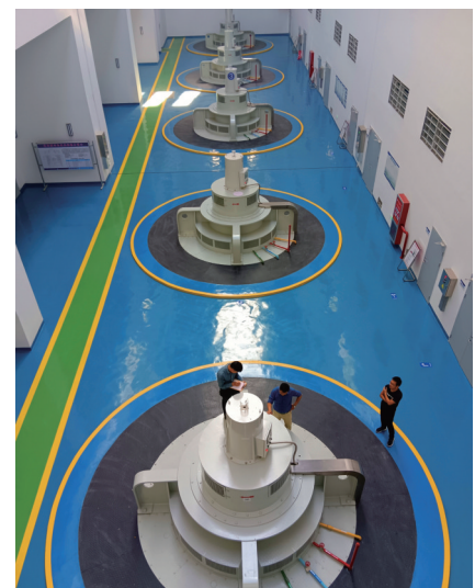
日前,安徽省重点工程——引江济淮枞阳船闸泵房,工作人员正在精心养护泵机,确保设备运转正常,及时有效地将长江水输入淮河,更好促进北方缺水地区的经济发展。
