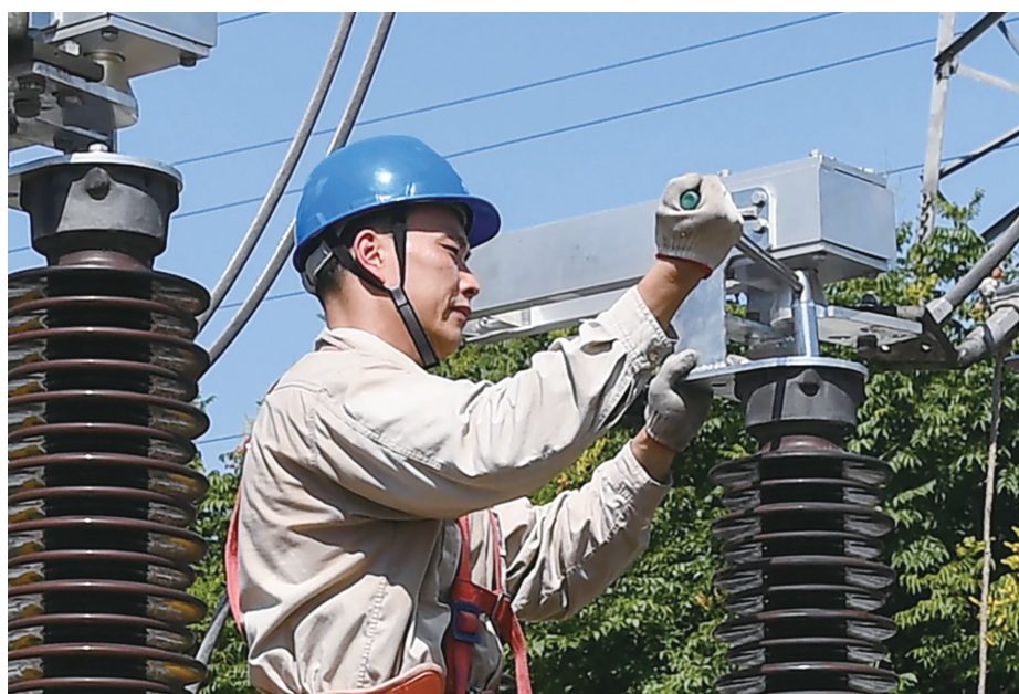
9月6日,国网镇江供电公司变电检修班人员来到位于丹阳市的500千伏访仙变电站,深入110千伏设备区对设备进行绝缘电阻、电容量、介损损耗等测试,确保设备安全稳定运行,由此拉开了镇江地区4座500千伏变电站全面秋检的序幕。
