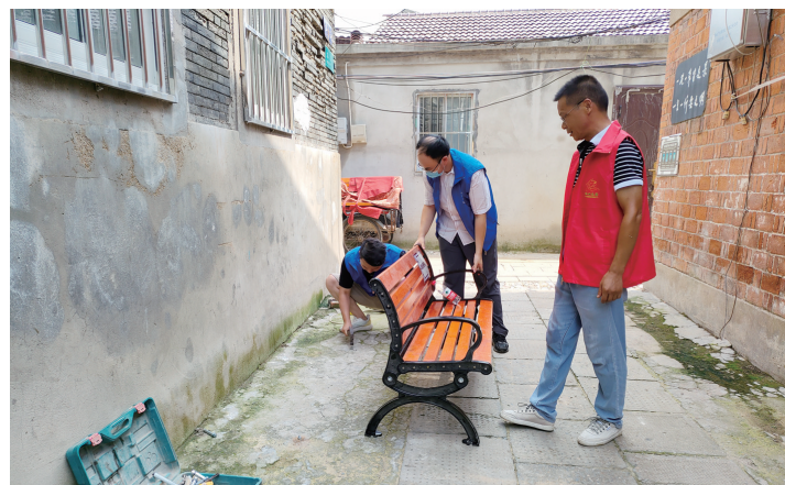
7月25日,金山街道银山门社区联合党建联盟单位润州区水利局开展“为‘爱心便民椅’换装”志愿活动,由于“爱心便民椅”长期经过雨打日晒,容易掉漆发霉,影响居民使用,党员志愿者对11张破旧长椅刷漆维护,并新增3处便民椅,满足居民纳凉、歇脚需求,截至目前,社区已累计安装“爱心便民椅”57张。
