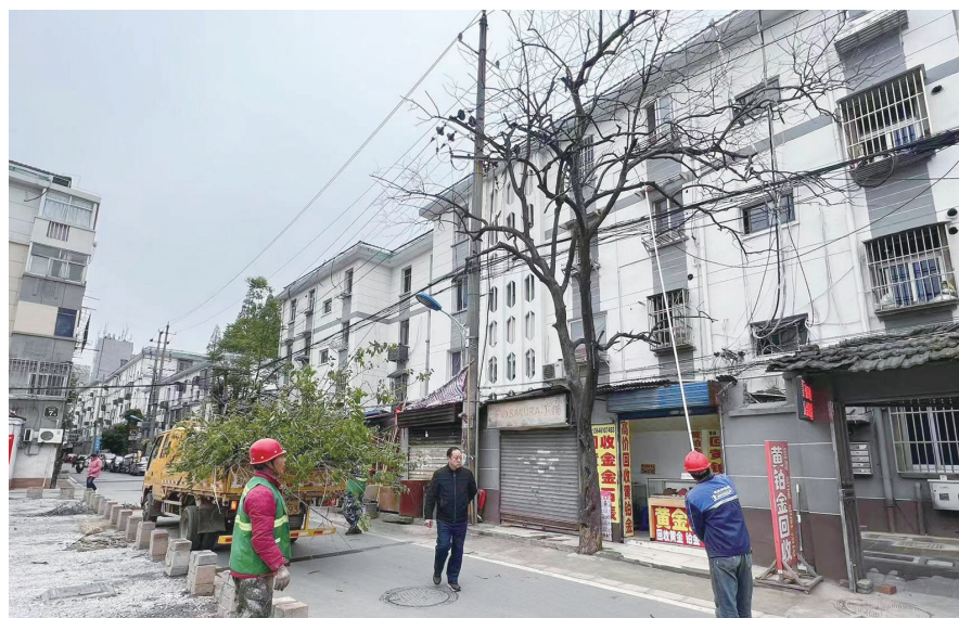
永安路18号门前有两棵枯树，影响居民出行安全。尚友社区闻讯后，多方协调，4月25日，组织专业人员对枯死树木进行清理，为周边群众消除安全隐患，有效确保了居民和过往群众的通行安全。 管茹 王呈 摄影报道
