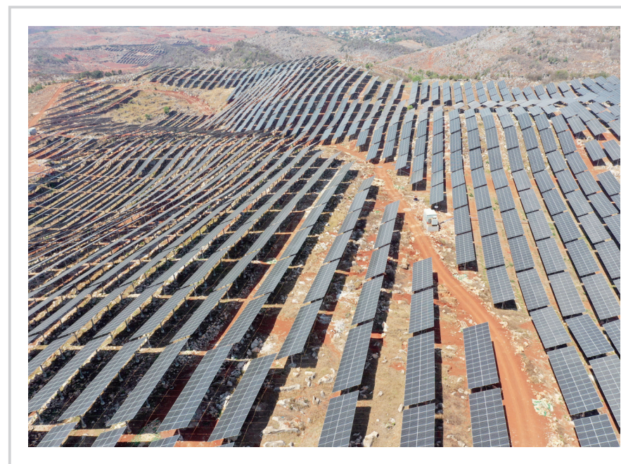
近年来,云南省文山壮族苗族自治州砚山县科学利用光伏资源,结合石漠化治理、生态修复、种养业发展等,在石头上因地制宜建设“光伏+”综合利用项目,助力乡村振兴。图为平远小石岩光伏电站(无人机照片)。新华社发
