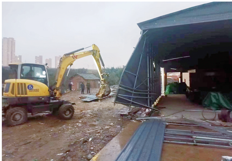
近日,镇江新区丁卯街道城管办联合属地中队、戴家巷社区等相关部门对金之桥装饰城内近600平方米的违法搭建进行助拆,对该违建安全拆除落地。丁卯街道城管办将继续加强巡查力度、加大拆违力度,为城市文明护航。 任子悦 马镇丹 摄影报道
