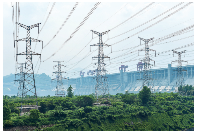
截至5月4日,三峡集团长江干流乌东德、白鹤滩、溪洛渡、向家坝、三峡、葛洲坝6座梯级水电站多年累计发电量突破3万亿千瓦时。目前,6座梯级水电站已投产的发电机组为101台,装机容量为6200多万千瓦,约占全国水电装机容量的16%。新华社发
