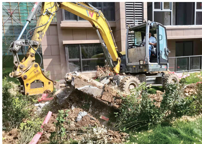
4日,丁卯街道城管办联合镇江新区行政执法局及相关社区,协助金科悦园物业管理公司对金科祥生悦园1-6幢一楼违法圈占公共绿地的违建进行集中助拆,做到查处违法建设节假日不停摆。
