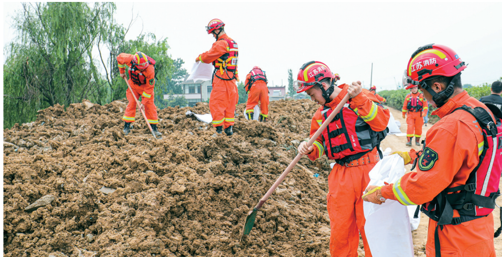
受持续高水位、大流量影响，四面环江的江心洲防汛形势依然严峻，为保障岛上人民生命财产安全，奋战在江心洲抗洪一线的防汛人员不惧风雨，始终保持高度警惕坚守在现场，做好隐患排查，妥善安置群众，全力打好防汛抗洪攻坚战。 谢道韞 摄影报道
