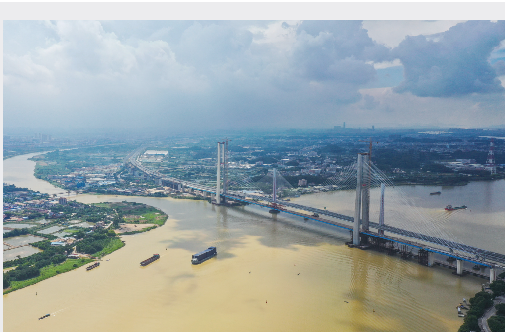
昨日，中铁十一局承建的粤港澳大湾区基础设施“硬联通”重点工程——广州南沙港铁路跨西江特大斜拉桥完成最后一组斜拉索吊装，大桥预计在7月底合龙。该桥位于广东佛山市和江门市交界处，全长1117.5米。
